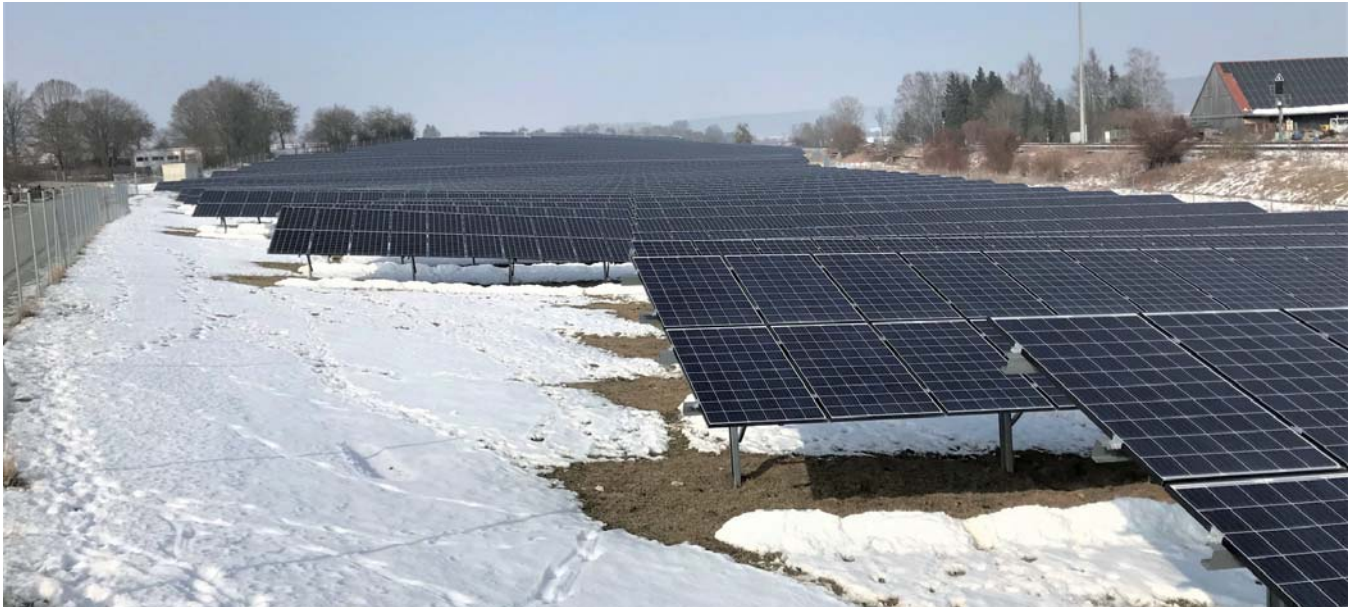
Solarmodule soweit das Auge reicht: Etwa 12.500 Solarmodule wurden entlang der Bahnlinie installiert.
