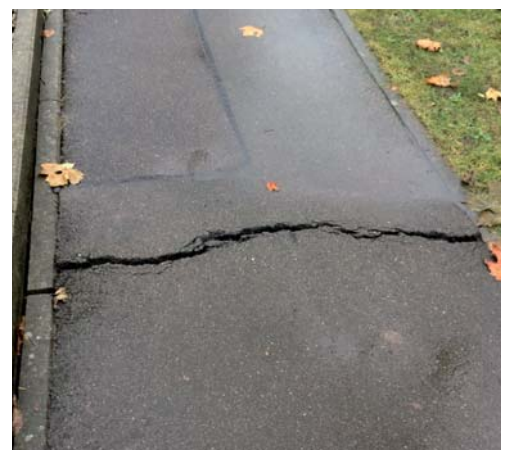
Große Risse im Gehweg als Stolperfalle.
